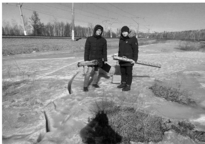
Образование бугра наледи у железнодорожной насыпи
